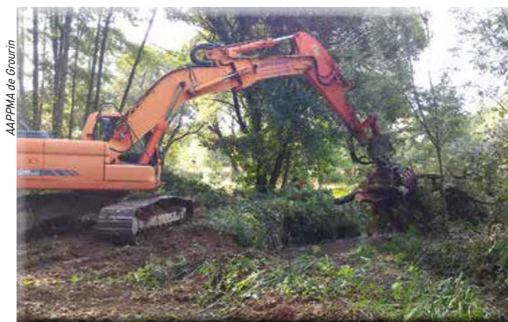
L'état d'encombrement de l'Inam a nécessité l'intervention d'une pelleuse munie d'une pince de manutention.
